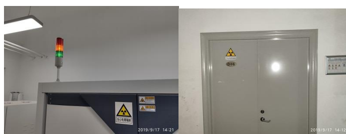
铅房上工作状态指示灯和电离辐射警告标志
